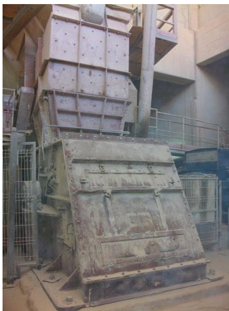
Fig. 4.1 – Britador primário de martelos
