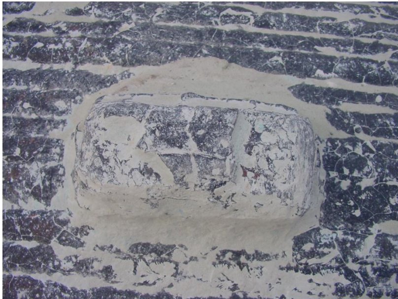
Fig. 5.15 – Desunião do revestimento com o metal de base
