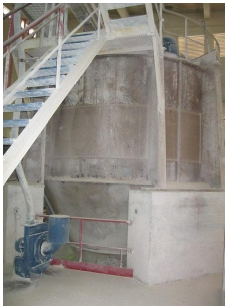
Fig. 4.16 – Separador da moagem de cru
