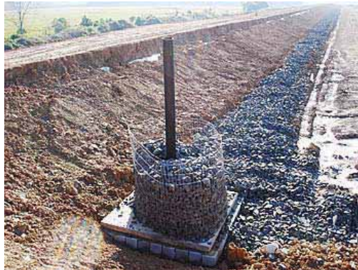
Figura 61 – Poço de biogás na fase de arranque (Ambirumo)
